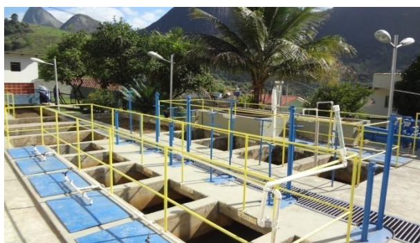
Figura 3-17 - Estação de Tratamento de Água.
